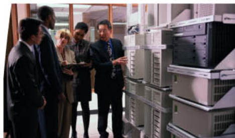
服务器与数据储存器, 有源网络设备等。
