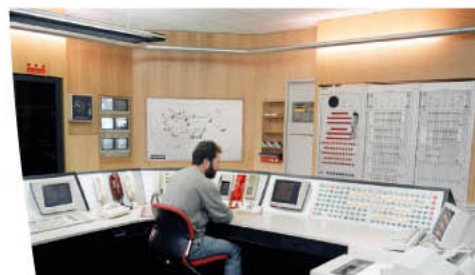
智能化现场监控、通信控制机房等。
