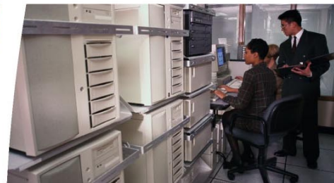
数据中心，服务器机房，通信中心，数据存储设备，网络设备
